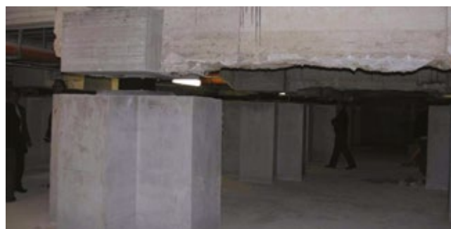
Inserimento di un isolatore elastomerico armato tra la fondazione esistente e una nuova sottofondazione
